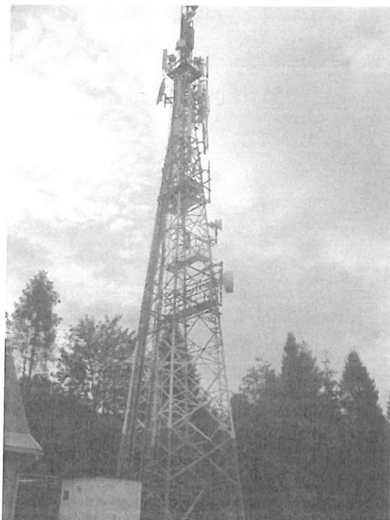
Zal. nr 1: Widok ogólny instalacji radiokomunikacyjnej.
